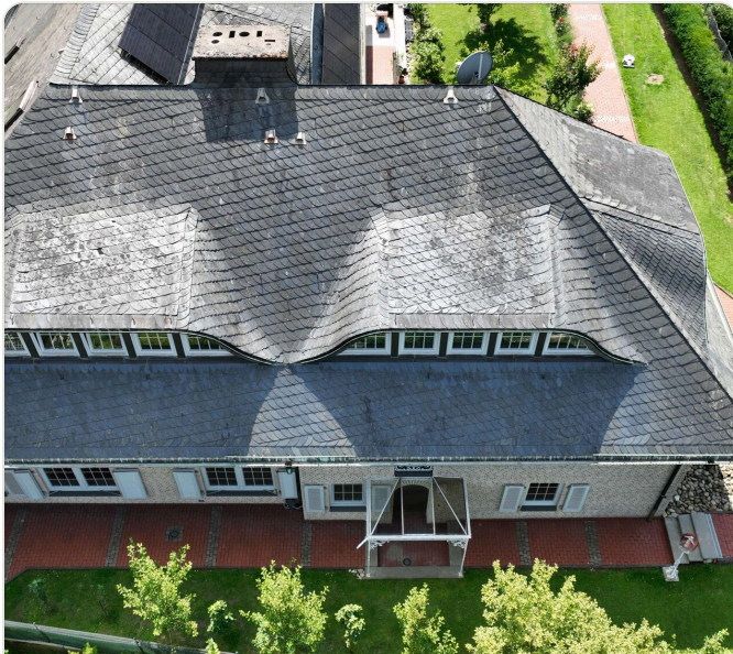
Fassade & geschwungene Gaube mit PV
